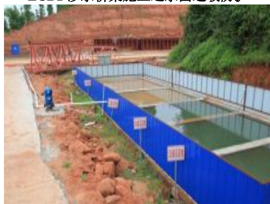
ZCB1 拌和站五级沉淀池
