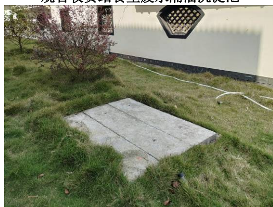
合什收费站食堂废水隔油沉淀池
