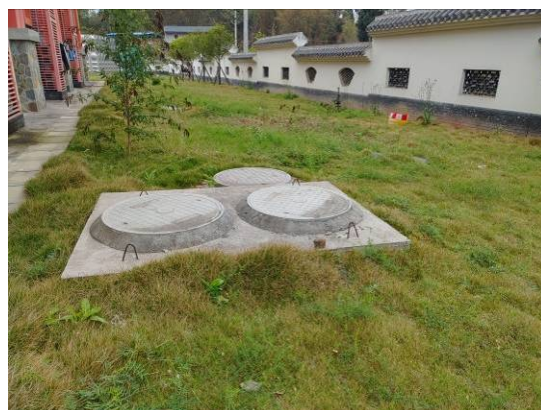
禄加收费站食堂废水隔油沉淀池
