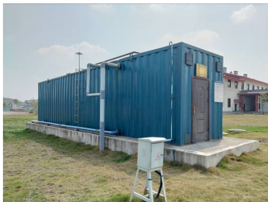
荣县南服务区污水处理设施
