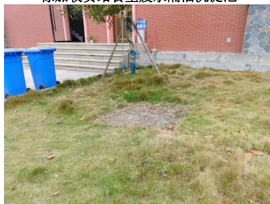
藕塘收费站食堂废水隔油沉淀池
