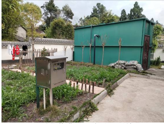
汪洋北收费站污水处理设施
