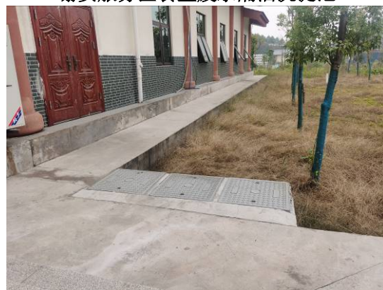
叙州服务区食堂废水隔油沉淀池
