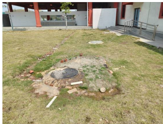
荣县南服务区食堂废水隔油沉淀池
