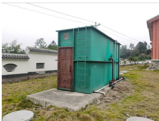
禄加收费站污水处理设施
