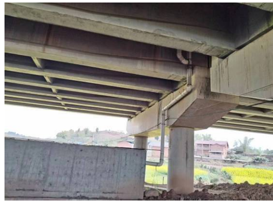
伍家坝大桥径流收集管网
