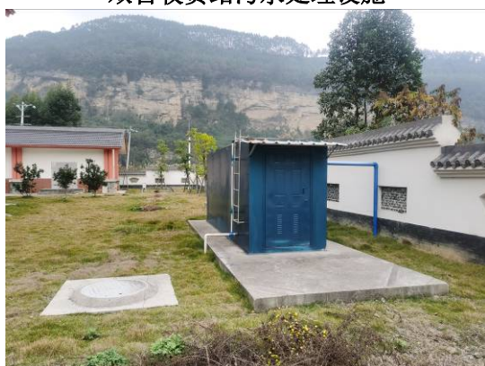
铁厂收费站污水处理设施
