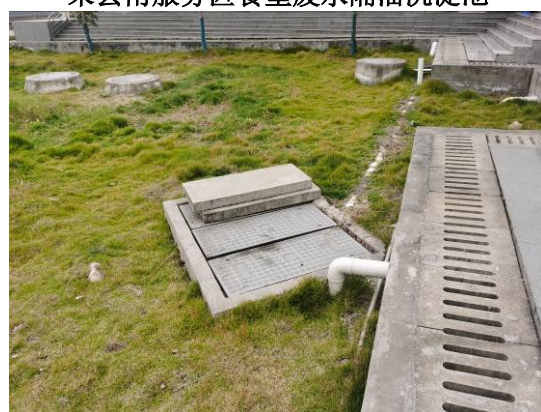
汪洋北服务区食堂废水隔油沉淀池
