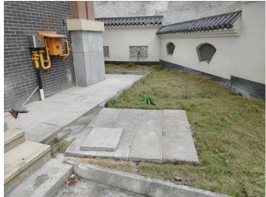
小河收费站食堂废水隔油沉淀池
