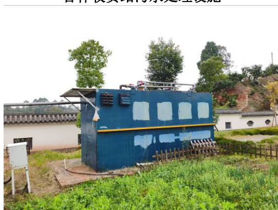
河口收费站污水处理设施
