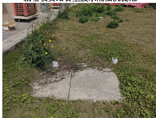
双古收费站食堂废水隔油沉淀池
