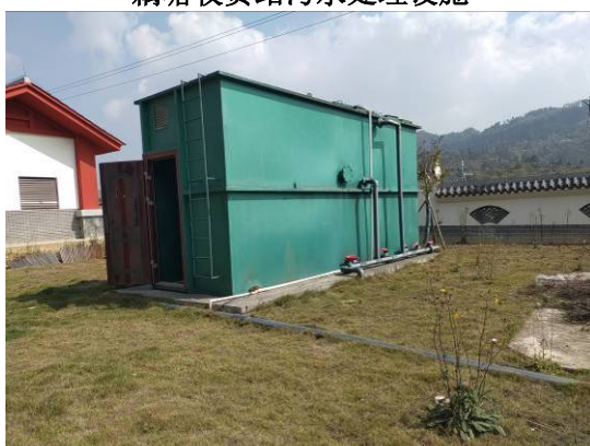
双古收费站污水处理设施
