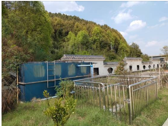
樟海收费站污水处理设施
