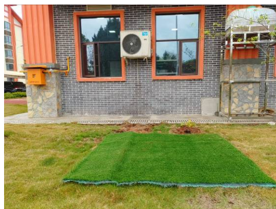
管理中心食堂废水隔油沉淀池
