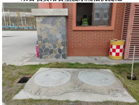
铁厂收费站食堂废水隔油沉淀池
