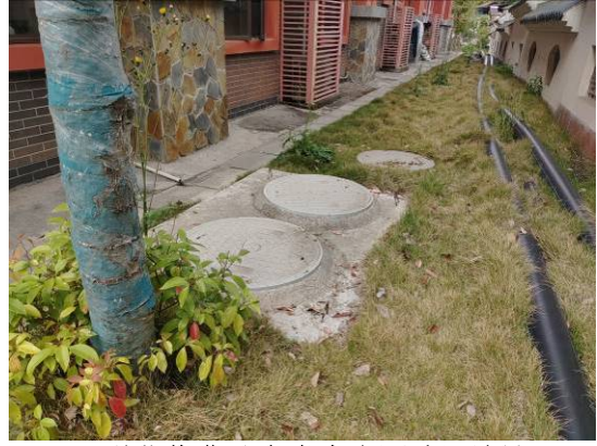
汪洋北收费站食堂废水隔油沉淀池
