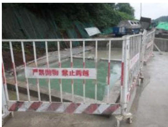
ZCB1-2 拌和站沉淀池
