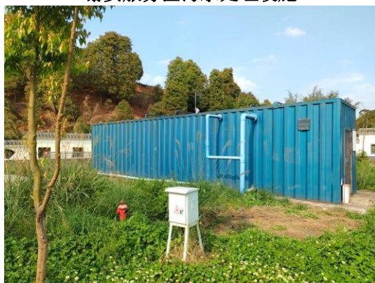
叙州服务区污水处理设施
