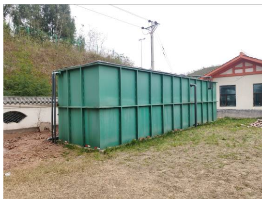
管理中心污水处理设施
