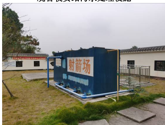
合什收费站污水处理设施
