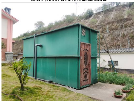
藕塘收费站污水处理设施
