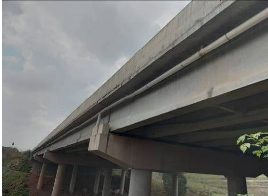
余家湾大桥径流收集管网
