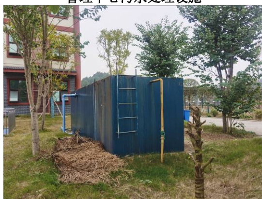
观音收费站污水处理设施
