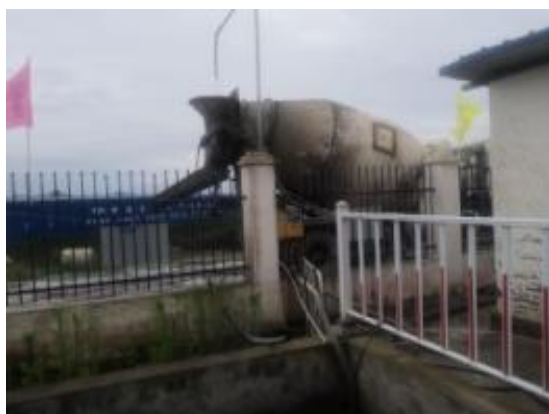
ZCB2 拌和站沉淀池废水处理后综合利用
