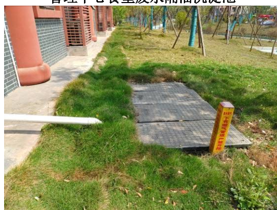
观音收费站食堂废水隔油沉淀池
