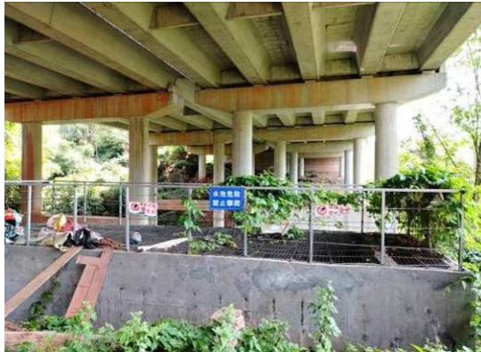
凉风河大桥隔油沉淀池
